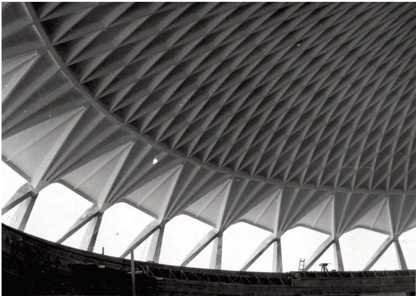
Interno del Palazzetto, con la sua cupola nervata, realizzata con elementi prefabbricati (MAXXI CA, Fondo Pier Luigi Nervi).
