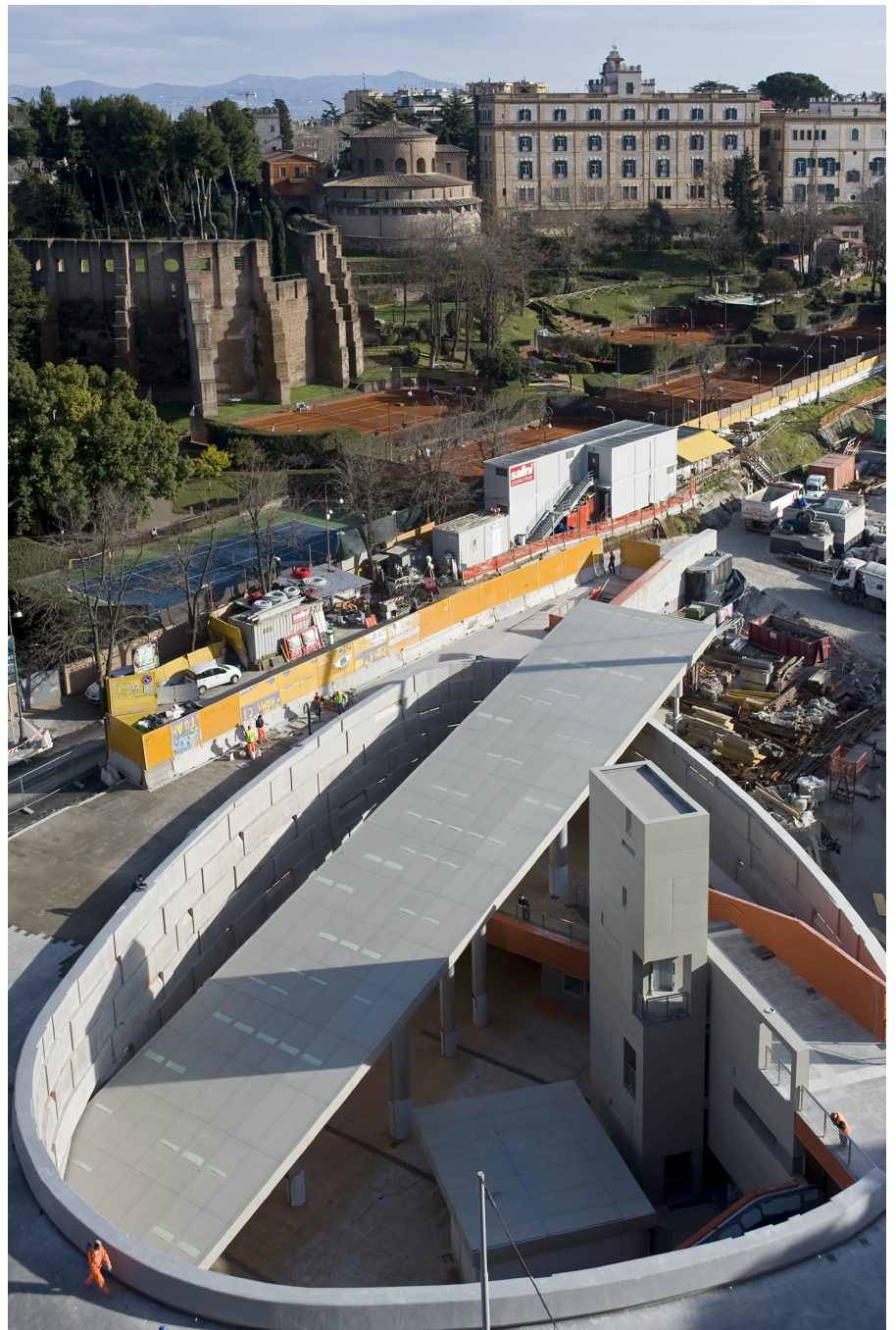
3/Stazione della Linea Metro B1 "Annibaliano", vista dall'alto. ABDR Architetti Associati. (Credits: Archivio ABDR, foto M. Maggi).
